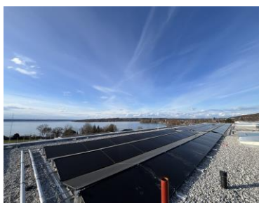
Bild 03: Pilotprojekt am Ammersee: Auf dem Schuldach in Herrsching liefern die neuen Kollektoren der TWL-Technologie GmbH regenerative Wärme und Strom.
