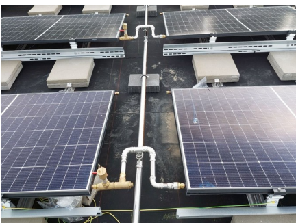
Bild 02: Doppelter Nutzen: 48 Photovoltaik-Thermie-Module der TWL-Technologie liefern elektrischen Strom und thermische Energie. Copyright: ISFH
